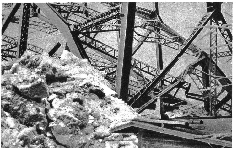
Die Eismassen an den Fundamenten der Brücke
