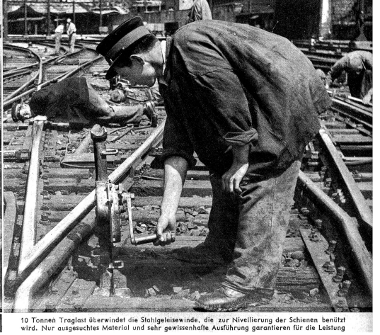
10 Tonnen Traglast überwindet die Stahlgeweiswinde, die zur Nivellierung der Schienen benützt wird. Nur ausgesuchtes Material und sehr gewissenhafte Ausführung garantieren für die Leistung
