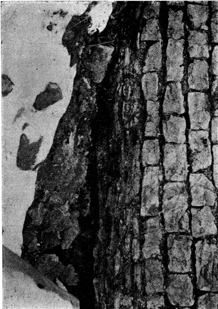
Textabbildung 2: Mauer der Periode III b mit Fundament aus bituminösem Kalkschiefer (siehe W 2, Tafel J).
