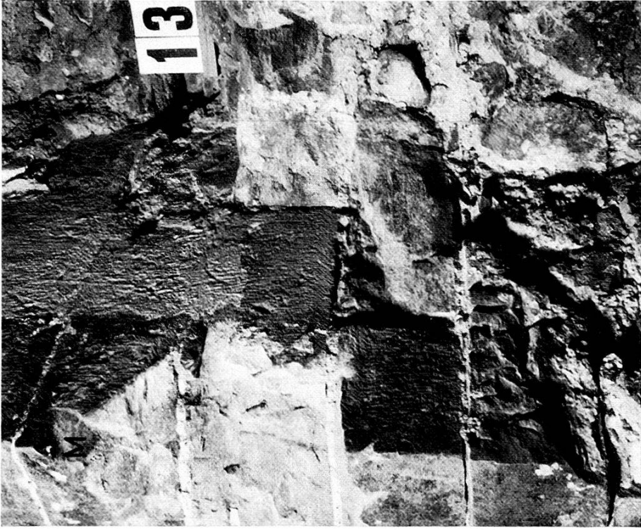
Tafel 7 A. Kryptenzugang. Vgl. zu dieser Detailaufnahme die Abbildung 10 mit ausführlicher Beschreibung; Deutlich zu erkennen sind die abge- schlagenen Stufen der ursprünglichen Treppe und der darauf abgestellte Mauerwinkel M, dessen Verputz gegen das Mittelschiff streicht. Hinter der Photonummer ist bereits die Störung durch den modernen Heizkanal zu erkennen. Photo: W. Geiger.
