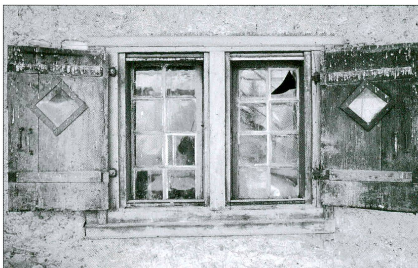
Fig. / Abb. 7 Rez-de-chaussée sud, fenêtre géminée, cadres de bois (1797/1798) Südliches Erdgeschoss: Doppelfenster mit Holzrahmen (1797/1798)
