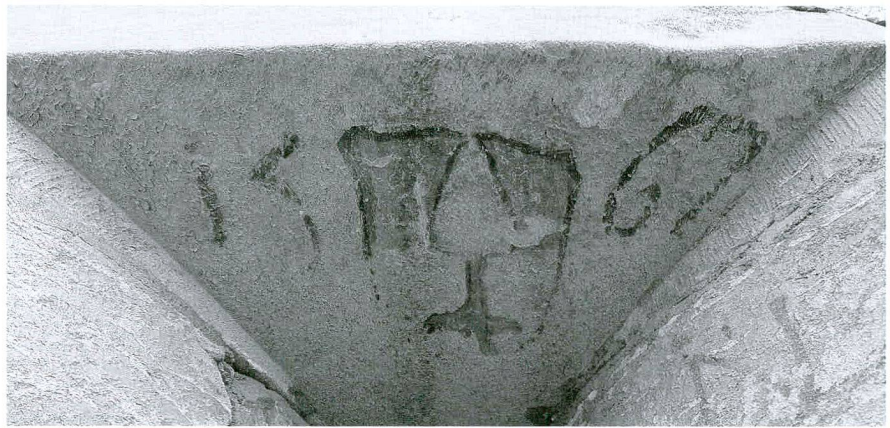
Fig. 7 Facade sud, troisième étage: armes de Nicolas Lombard accompagnées de la date de 1567 (état avant réfections)
