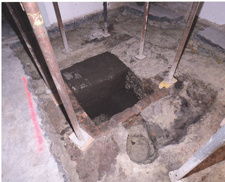
Fig. 22 Rez-de-chaussée, fosse et rigoles pour les lambourdes du plancher de la boutique/ouvroir, époque moderne
