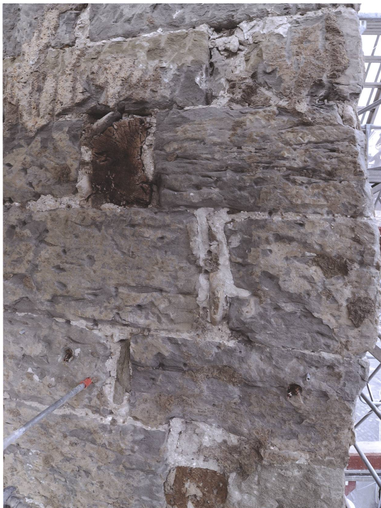
Fig. 5 Première phase, premier étage, tête de poutre en chêne de 1251-1267 liée à la maçonnerie de la muraille
