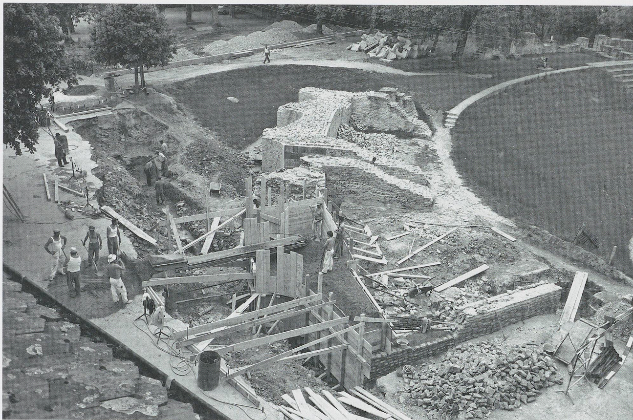
Fig. 37. Les hémicycles 25 à 27 et le vomitoire 9 en cours de restauration; à l'arrière, les hémicycles 21 à 24 restaurés en 1968. Juin 1971.
