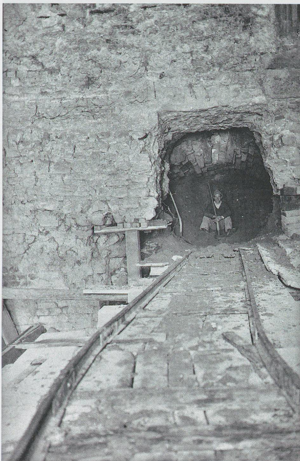
Fig. 27. Dégagement du couloir sud N à partir de son vestibule P ou «caveau de la pirogue»: les fondations de la façade ouest de la tour médiévale qui formaient bouchon ont été percées et les claveaux de tuf de la voûte du couloir apparaissent en place. 20 décembre 1946.
