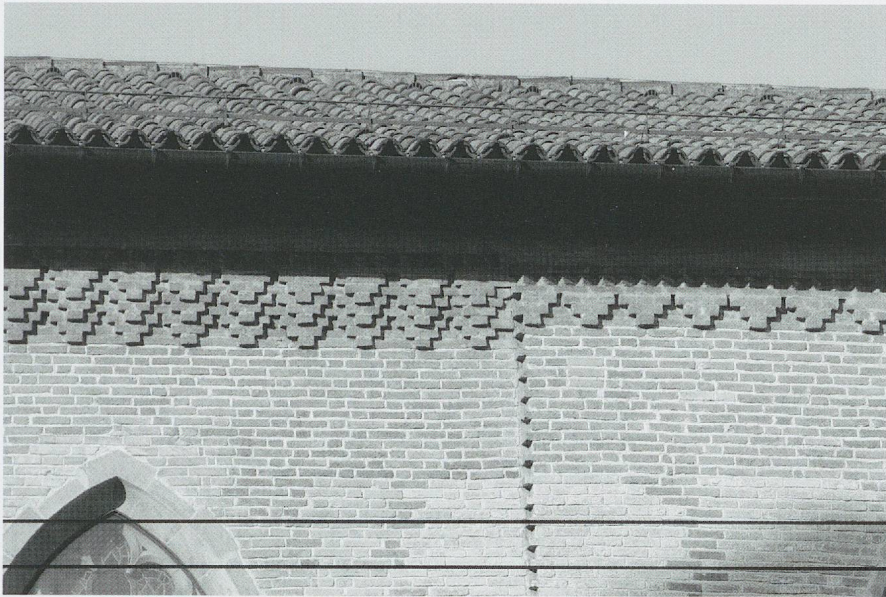
Fig. 100. L'église Saint-Gervais à Genève, de 1436 à 1449 environ. Détail de la rupture du décor de la corniche en brique au sud de la nef, ouvrage en partie de Pierre Mascrot, d'Agliè en Piémont, maçon-carronnier et paroissien (photo MG, 2009).
