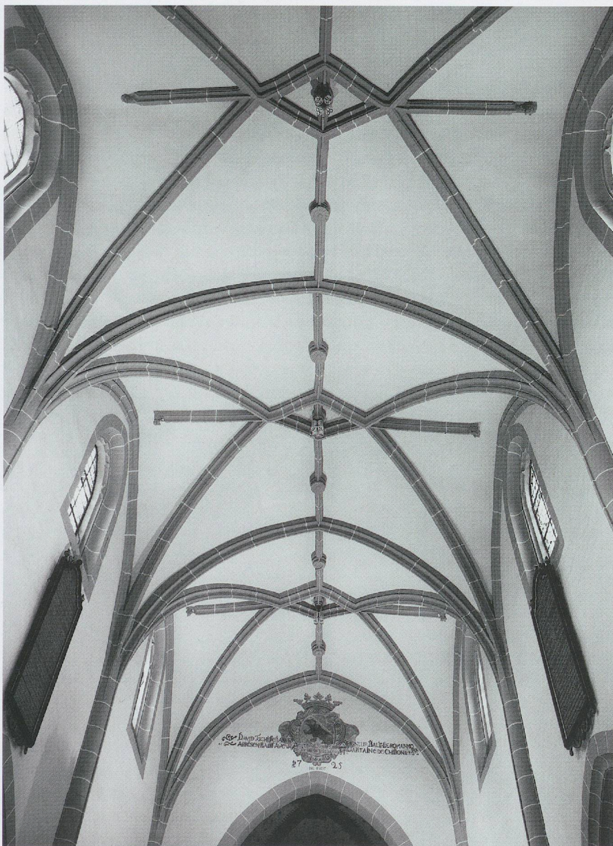
Fig. 370. L'église Saint-Martin de Vevey. Les voûtes de la nef, par François de Curtine (vers 1528–1532). Etat après la dernière restauration (photo Claude Bornand).
