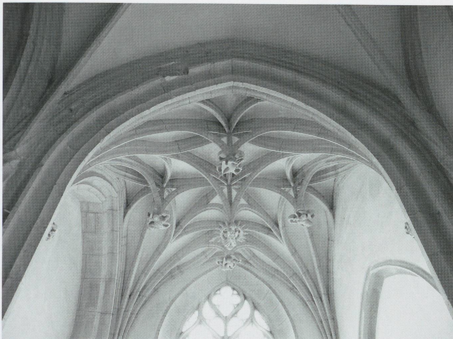
Fig. 564. L'église priorale de Mièges (Jura). La chapelle des Chalon: la voûte à clefs pendantes et nervures dédoublées de la travée orientale (fin XV e /début XVI e siècle), vue zénithale (photo MG, 2010).
