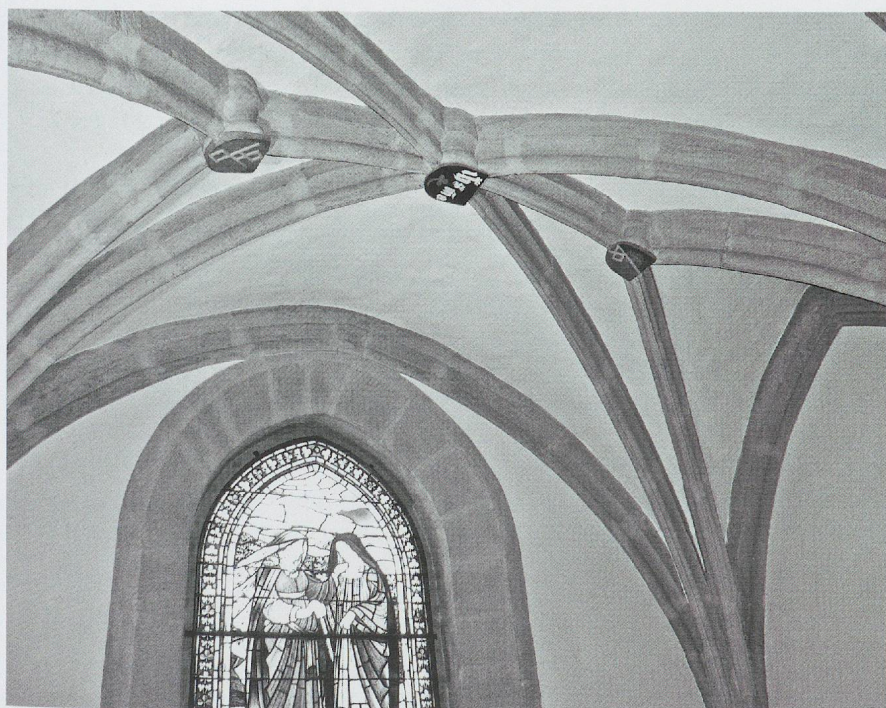
Fig. 673. La chapelle Clottu de l'église Saint-Pierre de Cornaux. La voûte à réseau semi-étoilé selon le modèle biennois (photo MG, 2010). Voir fig. 768.
