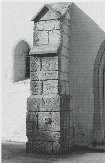
Fig. 712. L'église des Verrières. L'un des contrefort au sud de la nef (photo MG, 2009).
