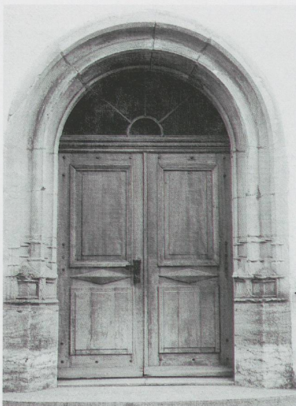
Fig. 1114. L'église paroissiale de Grancy VD. Le portail en plein cintre qui subsiste (photo MG, 1969). Voir l'une des bases très originales: fig. 755.
