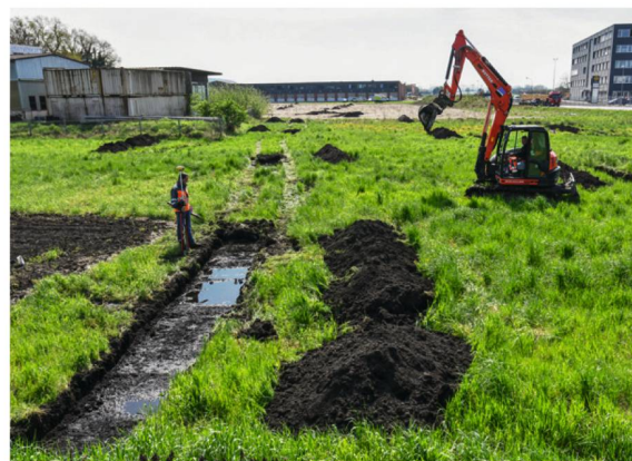
13 Bereich von Derrière les Murs , rund 50 m nördlich ausserhalb der Stadtmauer (Abschnitt T IV, Teilstück PN-T17_M1). Die unter Wasser stehenden Sondierschnitte bezeugen den in diesem Bereich hoch stehenden Grundwasserspiegel (Ausgrabung 2016.06).
