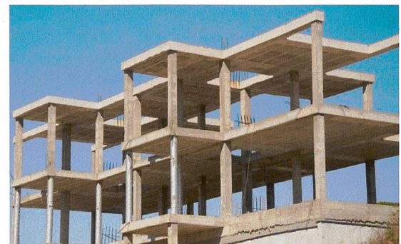
Abb. 8: Gemeinschaftliche Objekte – Die statischen Elemente eines Gebäudes (Bauteile) wie Stützen, Boden, Decke, Dach
