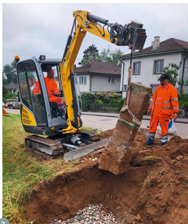
Figures 3 et 4 : une excavatrice soulève puis repose la borne pesant près de 400 kg – il faut s’y mettre à trois pour dresser la borne (© P. Reimann)
