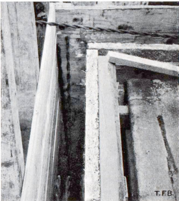
Abb. 2 Isolierung einer Eisenbetonwand mit einer 5 cm versteinerten Holzwollplatte, die ebenfalls als Innenschalung dient.
