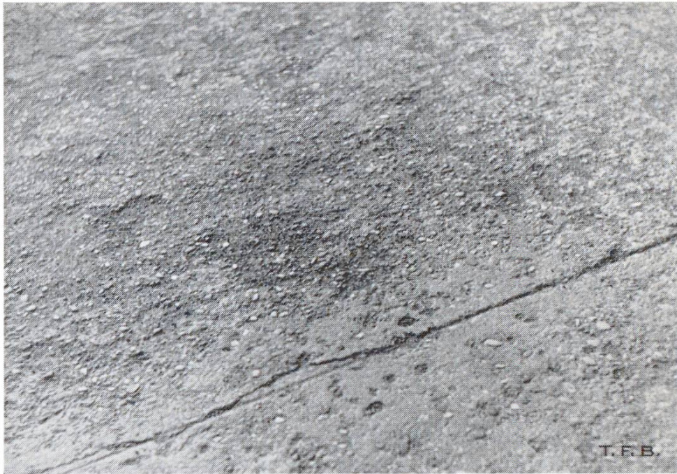
Abb. 6 Uebermässig starke Abnützung eines Cementbelags infolge Verwendung zu nassen Mörtels für die Abriebschicht
