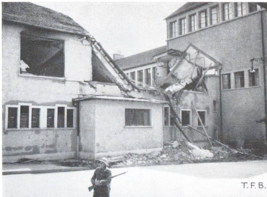
Abb. 6 Volltreffer in Eisen- beton-Hohlstein- decke. Einsturz der Decke durch Heraus- drücken einer Auf- lagemauer
