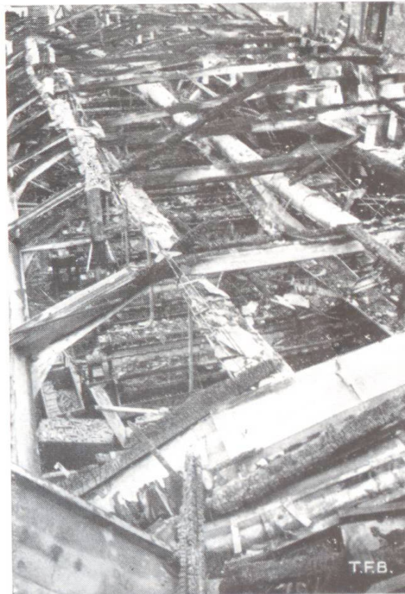
Abb. 8 Das Schadenfeuer erfasste nur den Dach- stock. Die darunterliegende Betondecke verhinderte ein Weitergreifen des Bran- des
