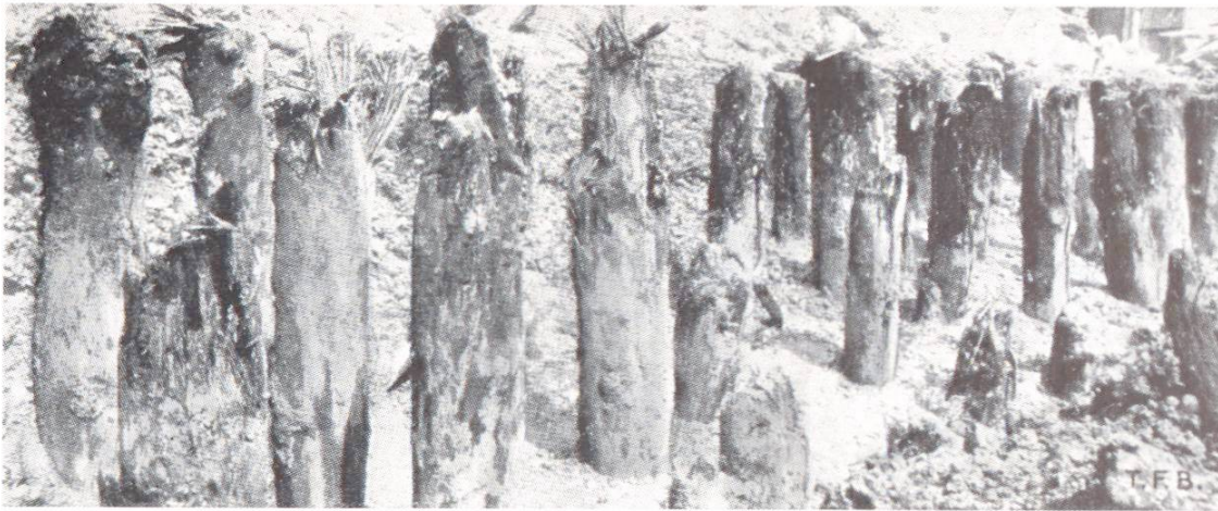
Fig. 5 Abgefaltete, hölzerne Pfahlköpfe, Zersetzung der über dem Grundwasserspiegel liegenden Partien (Phot. Raymond, NYC)
