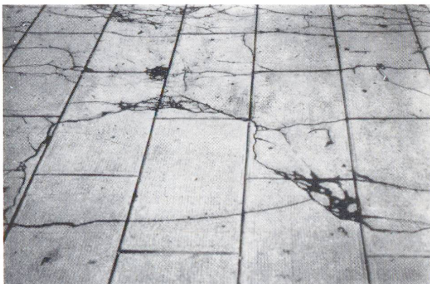
Abb. 3 Schäden an einem Cementbelag, verursacht durch Schwinden und Frosteinwirkung
