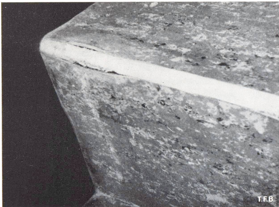
Abb. 1 Beginnende Zersetzung von Anticorodal-Leiste an Betontreppe.
