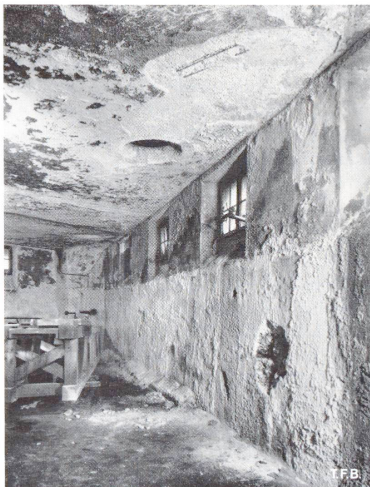
Abb. 1 Starke Oberflächenschäden verursacht durch säure- haltige Atmosphäre
