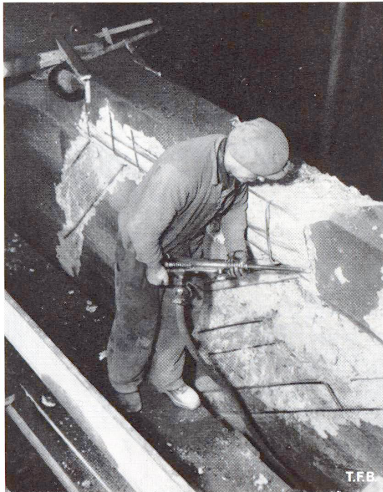
Abb. 3 Entfernung schadhaften Betons. Der Hammer wird zur Schonung der gesunden Teile möglichst schräg geführt
