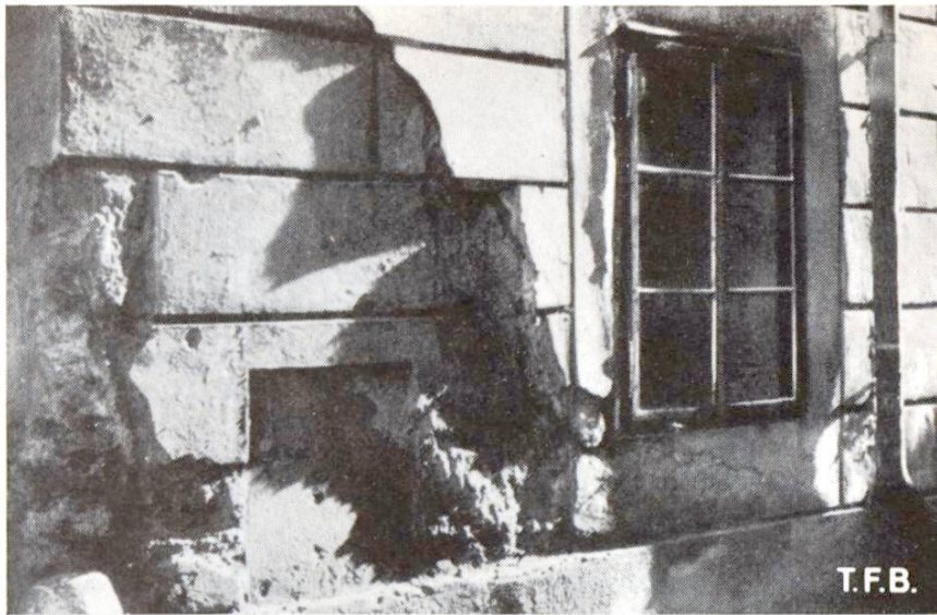
Abb. 5 Ablösung eines Mörtelüberzuges, der an einer zu glatten Fläche und zudem in zu grosser Dicke aufgetragen wurde. Die Dicke einzelner Putzschichten soll 2 cm nicht übersteigen
