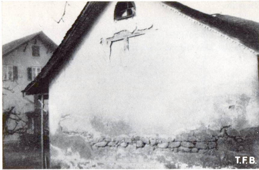
Abb. 2 Putzfläche unten zerstört infolge aufsteigender Bodenfeuchtigkeit, oben Ablösung wegen des verschiedenen Verhaltens von Holzbalken und Mauerwerk (inhomogene Grundfläche)
