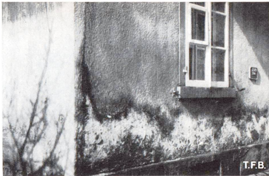
Abb. 4 Verfärbungen und Ausblühungen als Folge fehlender Horizontalisolation
