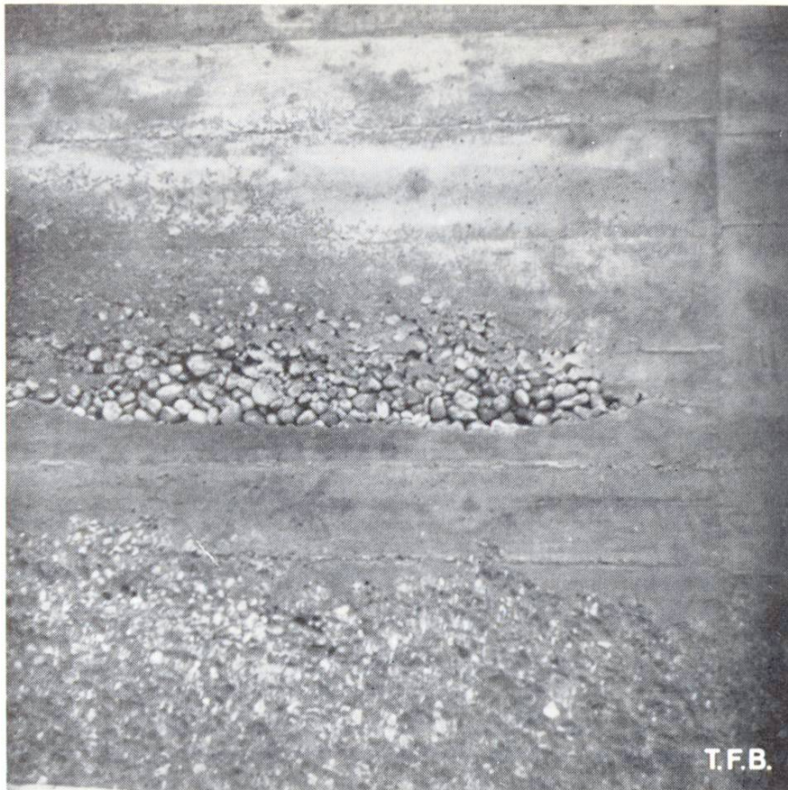
Abb. 4 Dieses Kiesnest wurde verursacht, indem bei relativ hoher Schalung direkt aus dem Transportkübel eingebracht wurde. Es hätte sich vermeiden lassen, wenn der Beton zunächst in eine Wanne gefüllt und dann eingeschaufelt worden wäre
