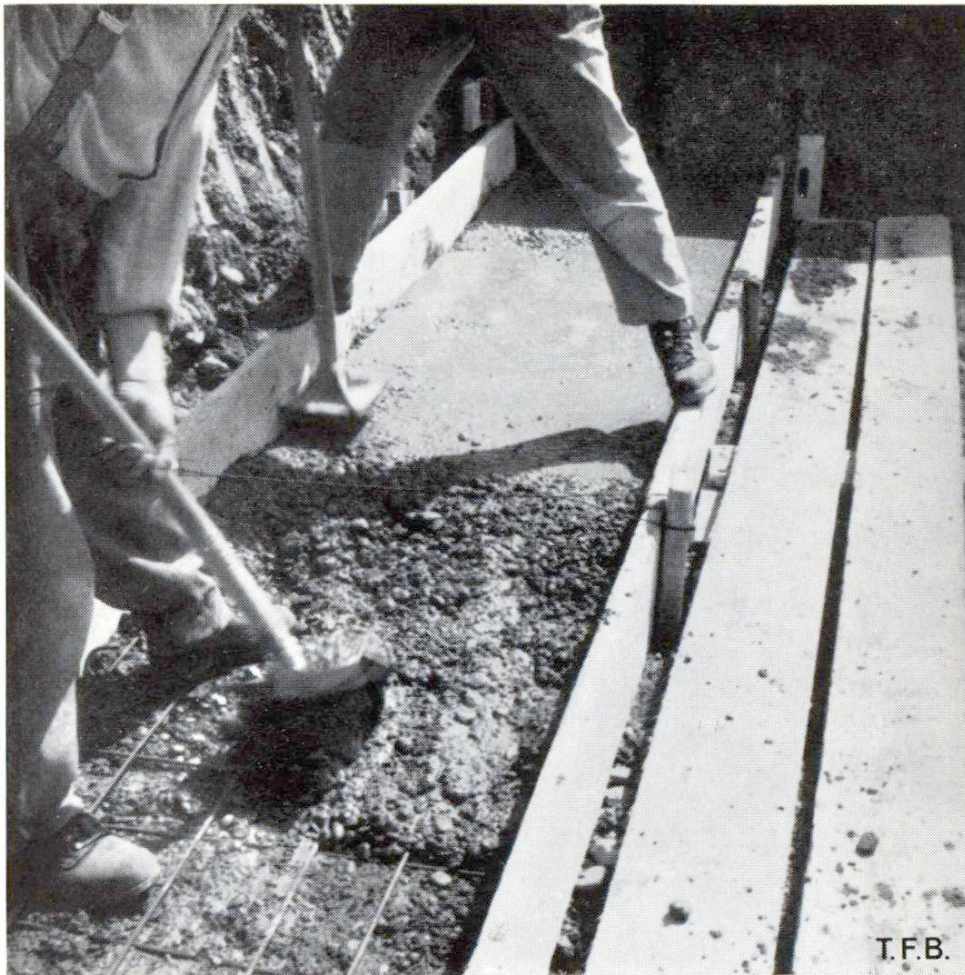
Abb. 9 Ein Fehler, der bei Bauarbeiten auf dem Lande noch vielfach angetroffen wird: Zu flüssiger Beton
