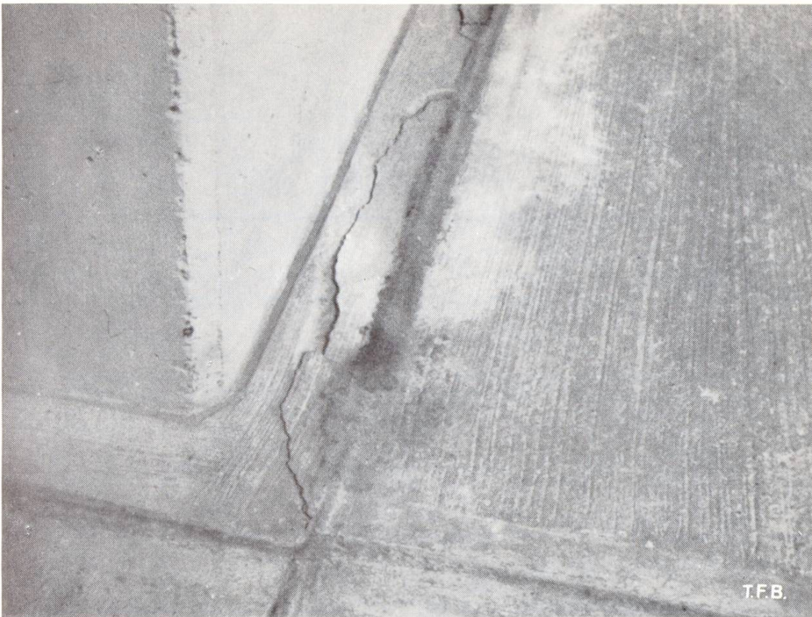
Abb. 5a und b Aussprengungen am Betonbelag entlang einer Gebäudemauer entsprechend Abb. 2b. Die Fuge sollte genau über der Fundamentkante liegen. An dieser Stelle stösst aber der wandseitige Belag etwa 5 mm über die senkrechte Trennfläche zwischen Fundament und Betonbelag hinaus und eine geringe Frosthebung genügte, um den Schaden herbeizuführen. Die Aufnahme rechts zeigt die Situation deutlich, insbesondere erkennt man die Spur der Dachpappeneinlage am ausgebrochenen Stück
