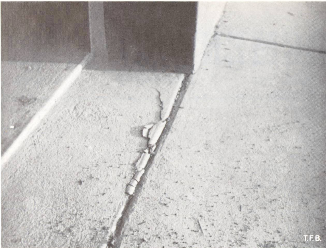
Abb.1 Zerstörung der Fugenkante infolge Verunreinigung der Fuge bei vorausgegangener Schwächung durch starkes Besprengen mit Wasser bei der Bearbeitung
