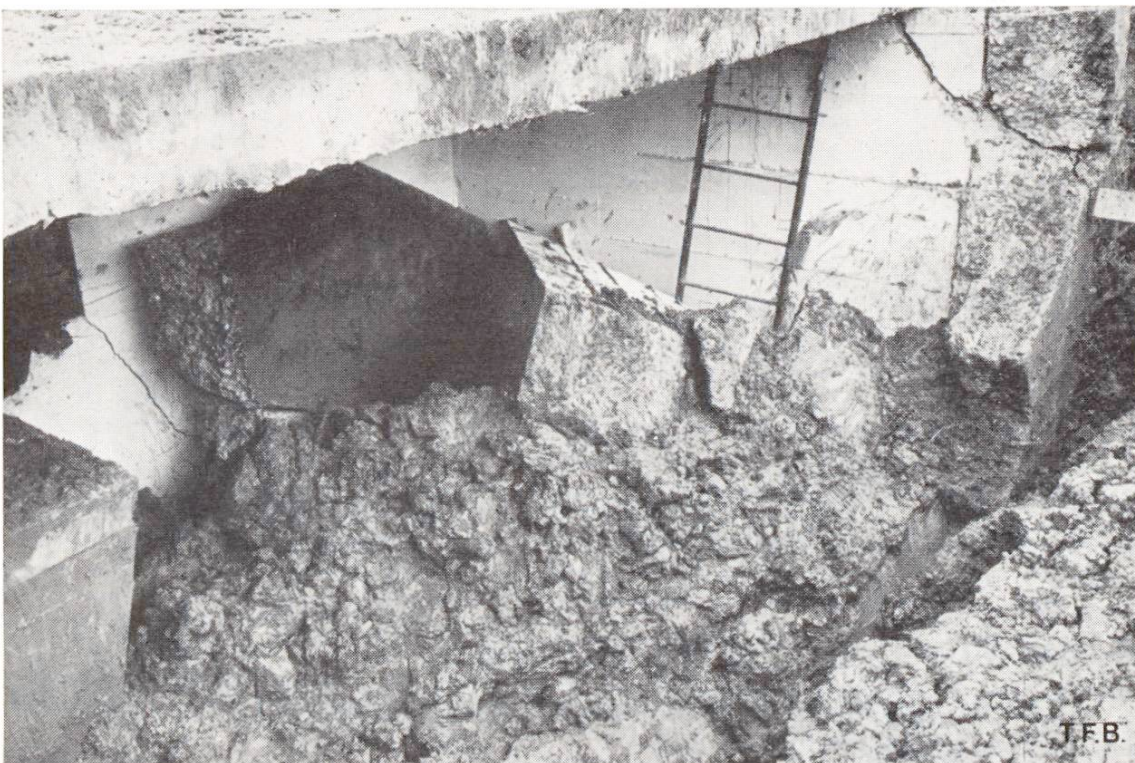
Abb. 2a Wirkung: Wand auf der ganzen Länge von 6 m eingeschlagen
