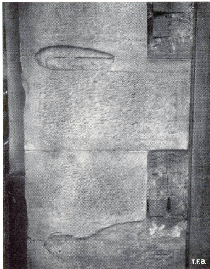
Abb. 2 Witterungsschäden an einem älteren Gebäude. Am Natursandstein sind Frostsprengungen verursacht durch undichte, zwischen Stein und Mörtel gerissene, Fugen eingetreten. In den kleinen Feldern zwischen den Quadern ist der Putz längst herausgefallen, lag er doch in Verbindung mit drei verschiedenen Baumaterialien und wurde damit seine Anpassungsfähigkeit auf eine allzu harte Probe gestellt
