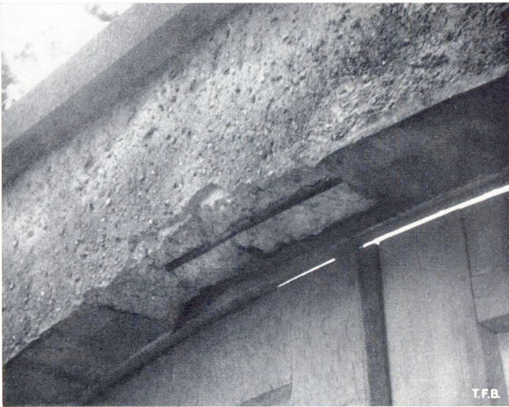
Abb. 3 Die Unterseite dieses betonierten Torbogens wurde mit einem sehr fetten Cementmörtel in beträchtlicher Dicke verputzt. Das unterschiedliche Verhalten zwischen dieser allzuharten Schicht und ihrer Unterlagen (relativ magerer Beton, Verputz mit HK-Mörtel) musste zu ausgedehnten Rissebildungen und schliesslich zur Zerstörung führen
