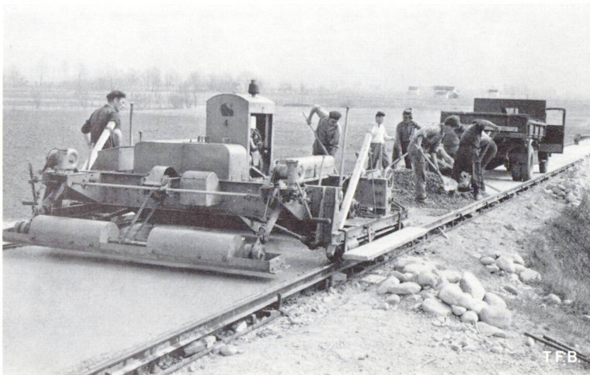
Abb. 4 Maschineller Einbau des Betonbelages. Normalerweise ist die Betonplatte 12 bis 14 cm dick und leicht armiert. Der Baufortschritt beträgt zirka 150 bis 250 m pro Tag
