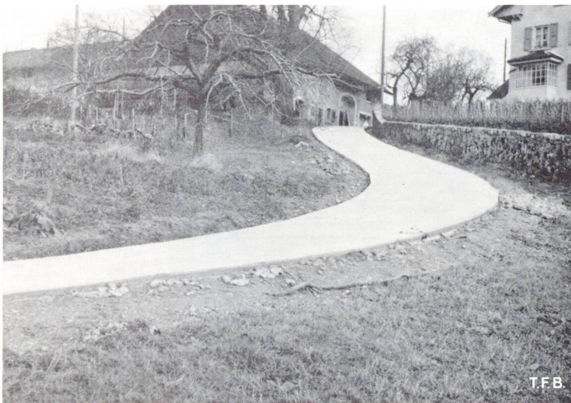
Abb. 8 Beton-Güterweg als Zufahrt zum Bauernhof. Auch Kurven im Gefälle lassen sich ohne besondere Schwierigkeiten ausführen
