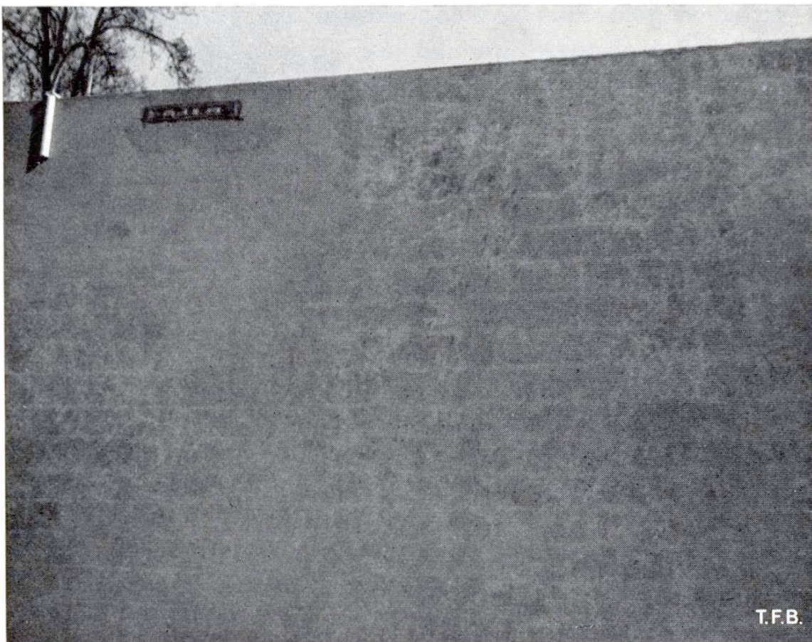
Abb. 4 «Durchscheinende Armierung», Wirkung wie Abb. 3 (Entmischung des Zementleims im Engnis zwischen Armierung und Schalung).
