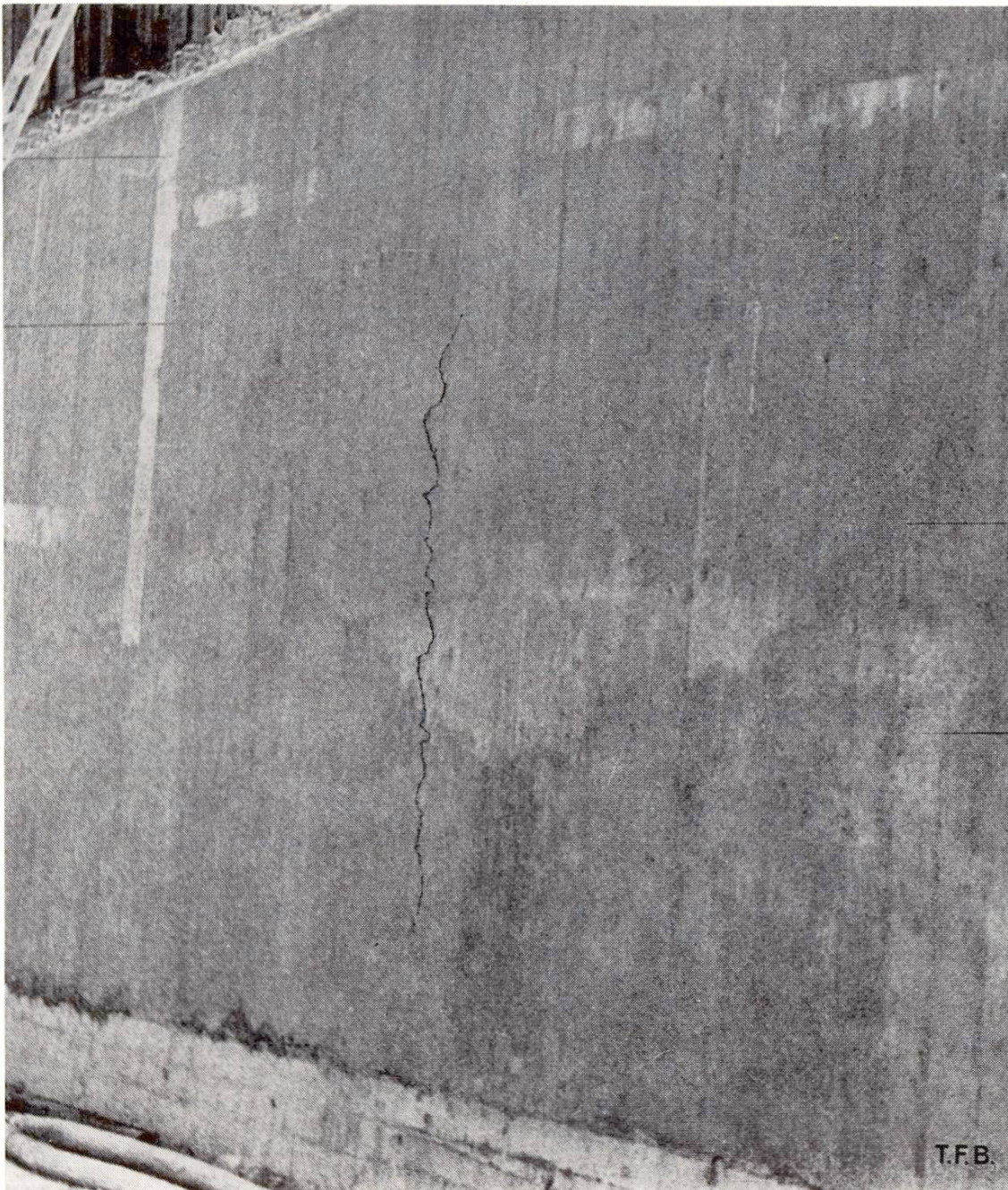
Abb. 1 Temperatur-Spaltriss in einer 80 bis 110 cm dicken Schwergewichts-Stützmauer (Riss leicht nachgezogen).
