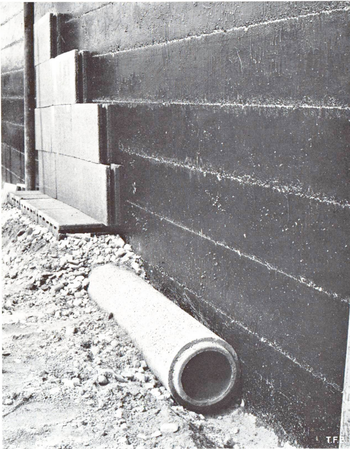
Abb. 3 Aufbau der Drainage einer Betonwand mit Hilfe von Sickerplatten, Filterschicht und Beton-Filterrohren. Dieses Bild zeigt deutlich, dass das Filterrohr erheblichen Druckbelastungen ausgesetzt wird und deshalb die notwendige Widerstandsfähigkeit gegen Verformungen aufweisen muss.
