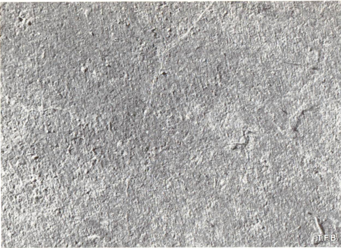
Abb. 2 Sehr feine, zugesinterte NetZRisse in Beton aus glatter Stahlschalung. Vergrößert, Bildbreite = 1 cm, Rissabstand 5 bis 10 mm, Rissweite 0,005 bis 0,01 mm, Risstiefe 0,5 bis 1,0 mm.
