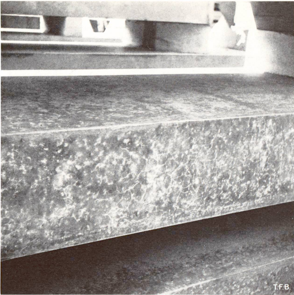
Abb. 6 Hell zeichnende feine Netzrisse an einem Betonelement aus Stahlschalung, Konzentration in der Flächenmitte, entstanden vermutlich aus Temperaturdifferenzen infolge hoher Zementdosierung. Der Beton ist sehr dicht und deshalb dunkel geblieben. Nur im Bereich der feinen Risse konnte sich heller Kalk ausscheiden.
