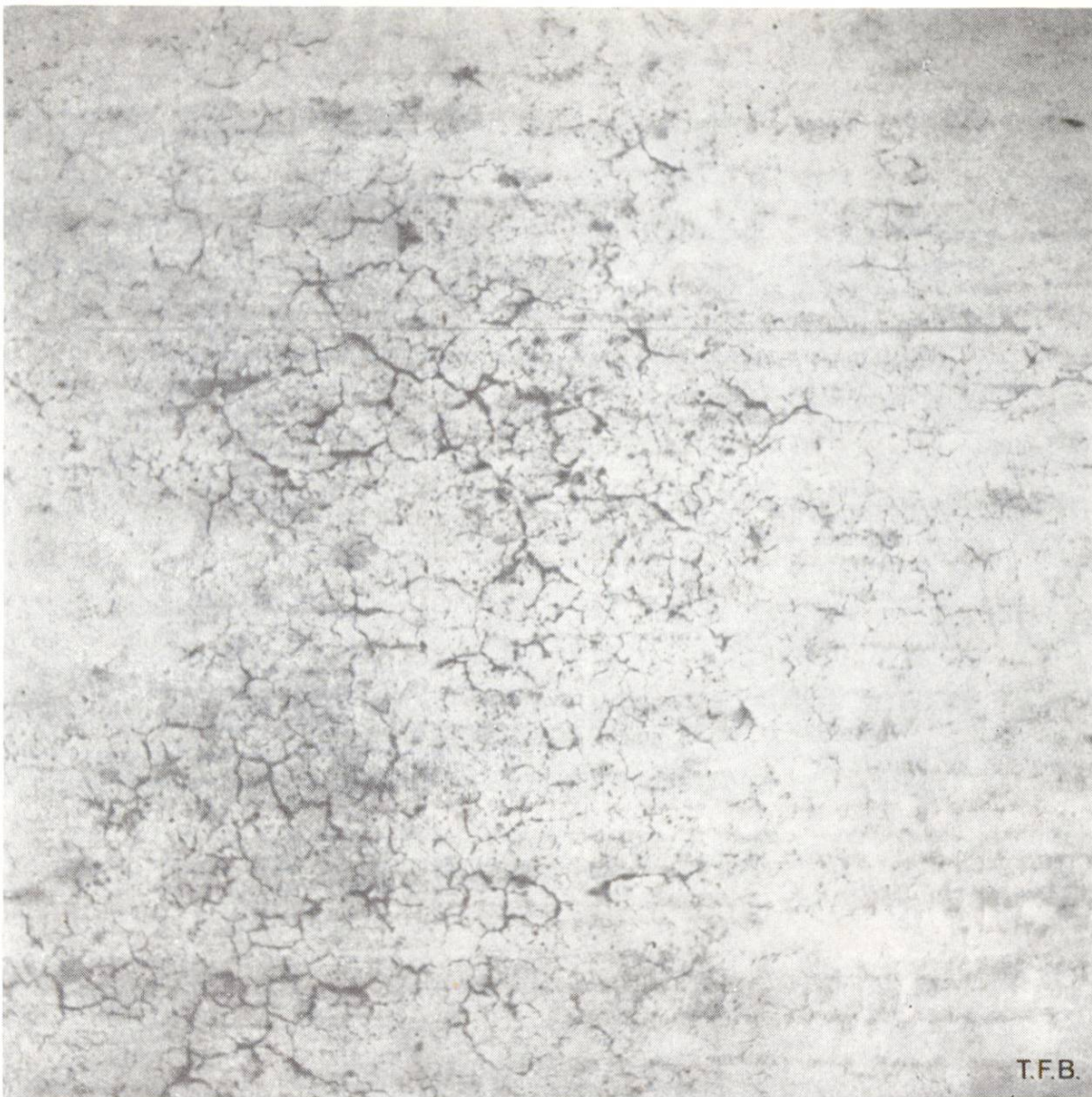
Abb. 4 Feine Netzrisse an einer glatten Betonoberfläche aus Stahlschalung, unregelmässig in der Fläche verteilt. Es sind viele Knotenpunkte mit mehr als drei Rissen zu erkennen. Das Rissbild deutet auf sehr frühzeitig, schon in der Schalung entstandene Schrumpfrisse. Dunkle Zeichnung wie Abb. 3, Rissabstand 10 bis 20 mm.
