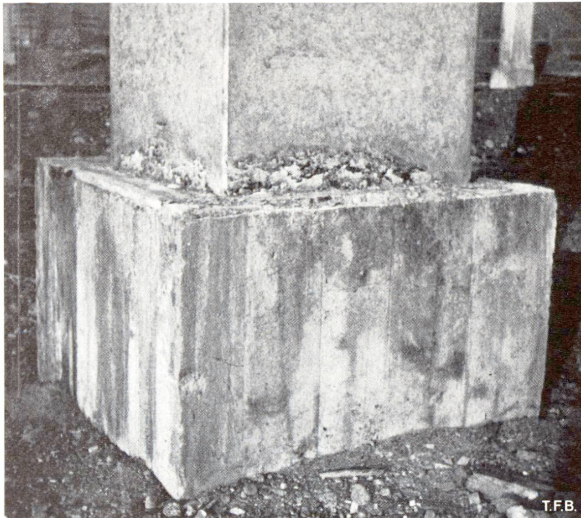
Abb. 7 Kiesnest am Fusse einer Säule (grosse Schütthöhe!) mit Bildung eines Korngerüstfilters und entsprechend ausgewaschener Körnung. Die Wirkung wurde verstärkt durch undichten Schalungsanschluss.
