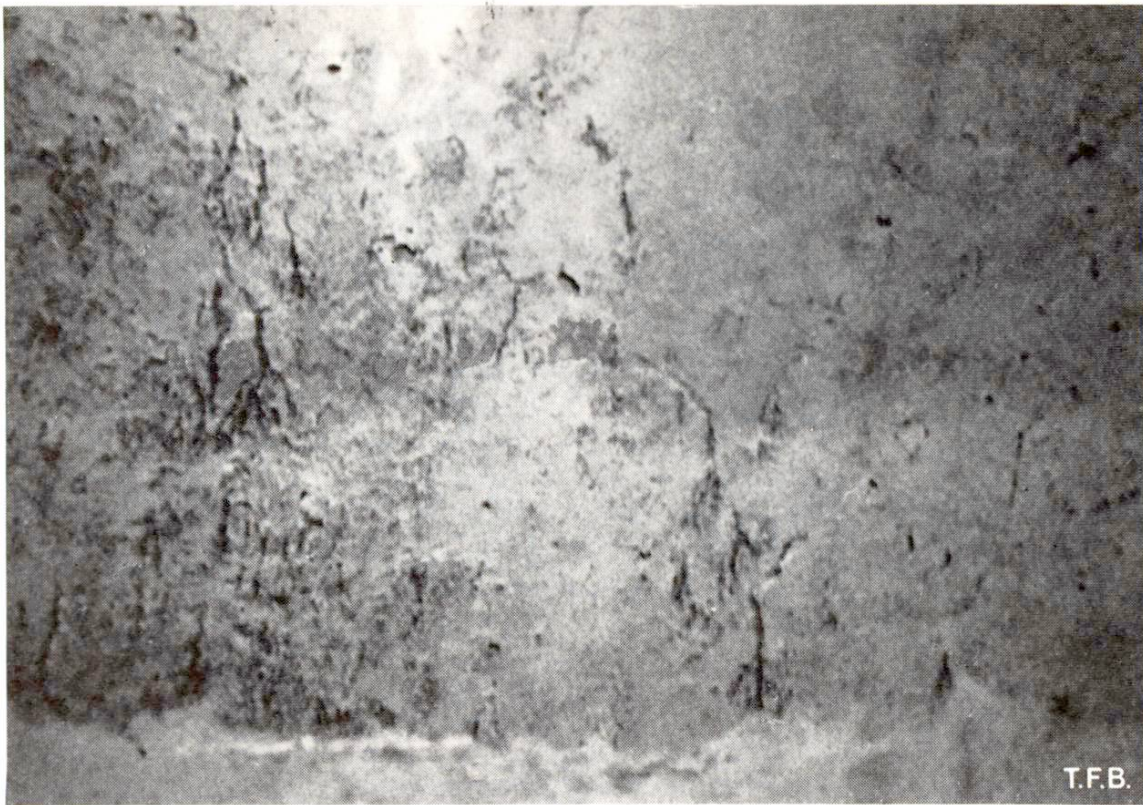
Abb. 8 Wasserausscheidung aus ausgefülltem Kiesnest im Bereich einer Betonierfuge bei zu flüssiger Betonkonsistenz.
