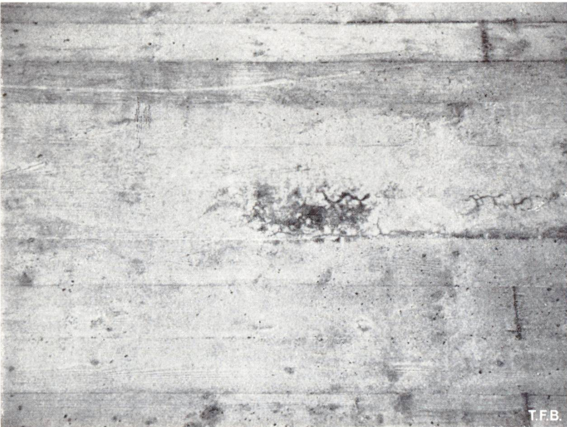
Abb. 5 Kleines, vollständig geschlossenes Kiesnest. Es sind nur noch die in diesem Falle besonders starken Verfärbungen zu sehen.
