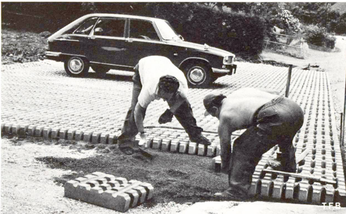
Abb. 2 Verlegen von Rasensteinen für eine Parkfläche. Die Elemente werden ähnlich wie eine Pflasterung in Sandbett verlegt, und die Öffnungen werden mit Humus gefüllt. Das Flächenverhältnis zwischen Beton und Erde beträgt ca. 1 : 2.
