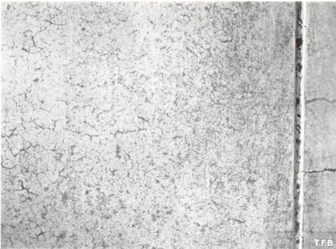
Abb. 2 Feines Netz von «Schrumpfrissen», die frühzeitig unter einer glatten, undurchlässigen Schalung entstanden sind. Am Rand haben sich weniger Risse gebildet.
