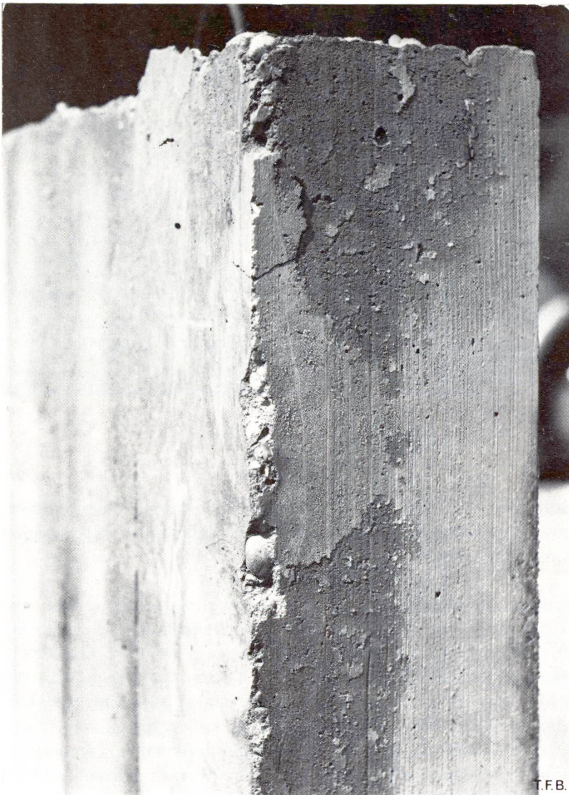
Abb. 4 Abstossen der Kante und Zementhautablösung als Folge von quellendem Schalungsholz bei «jungem Beton».
