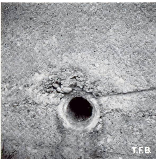
Abb. 3 Undichtigkeit bei einer Einlage
