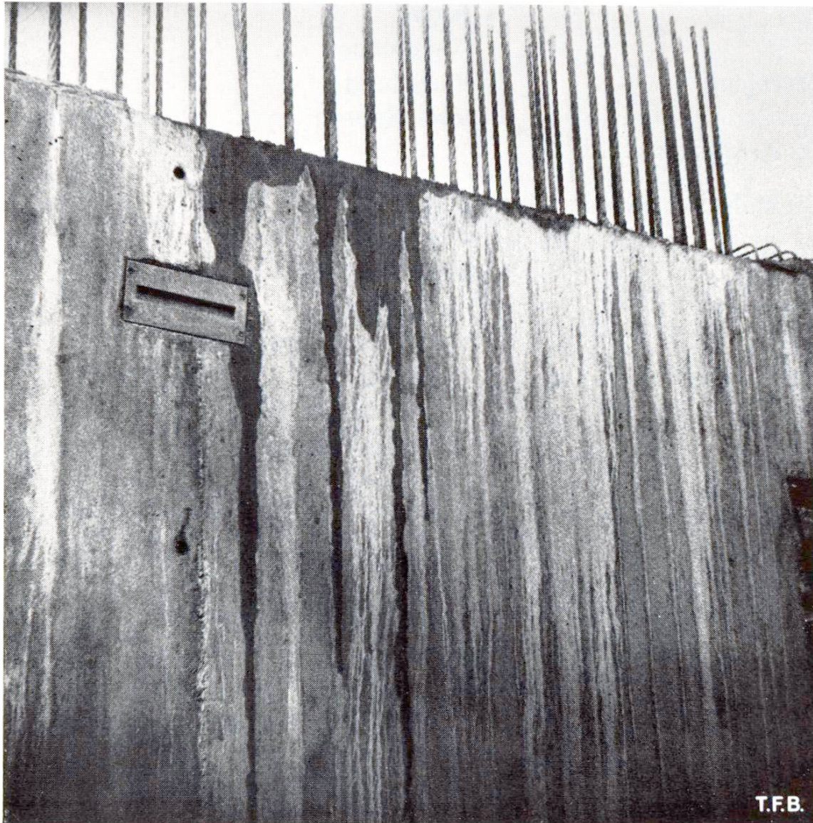
Abb. 8 Fehlende Abdeckung einer Mauerkrone
