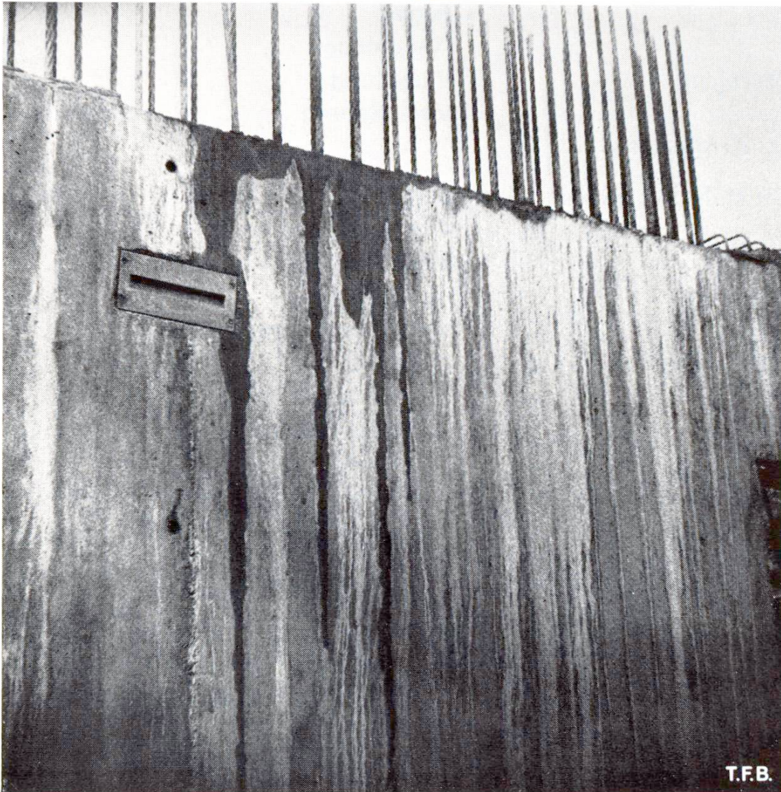
Abb. 8 Fehlende Abdeckung einer Mauerkrone
