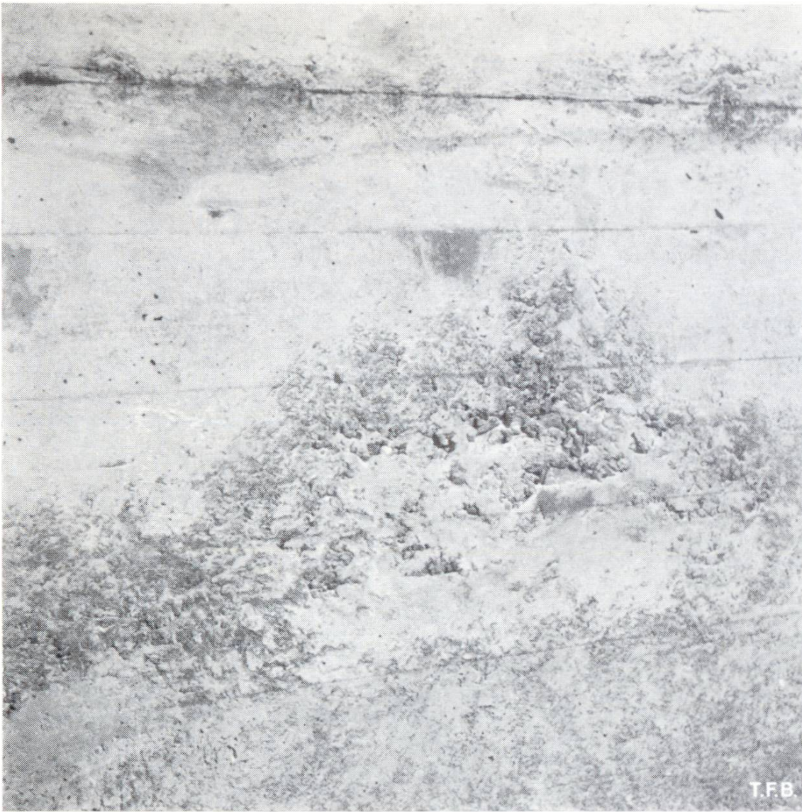
Abb. 4 Kiesnest, das unter der Rüttelverdichtung teilweise mit Betonmörtel zugefüllt wurde. Beim Fließvorgang haben sich Korngerüstfilter mit Anreicherungen von Zementteilchen gebildet, ähnlich wie bei undichter Schalung Abb. 2 und 3.
