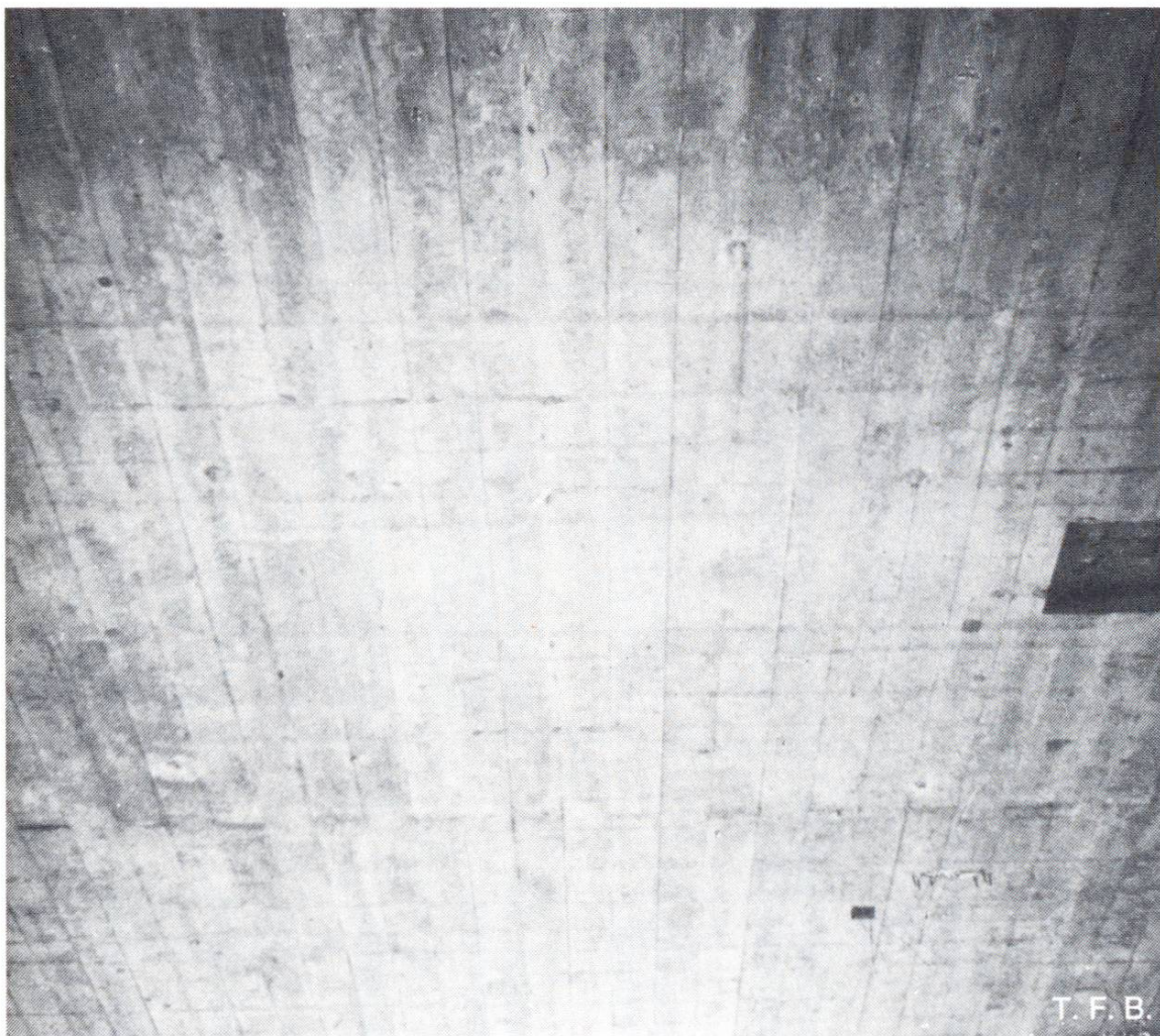
Abb.3 Strichförmige Rostflecken auf einer Betonunterseite. Stark rostige Bewehrungsstäbe wurden auf die Schalungsfläche ausgelegt und übertrugen dabei den Roststaub.
