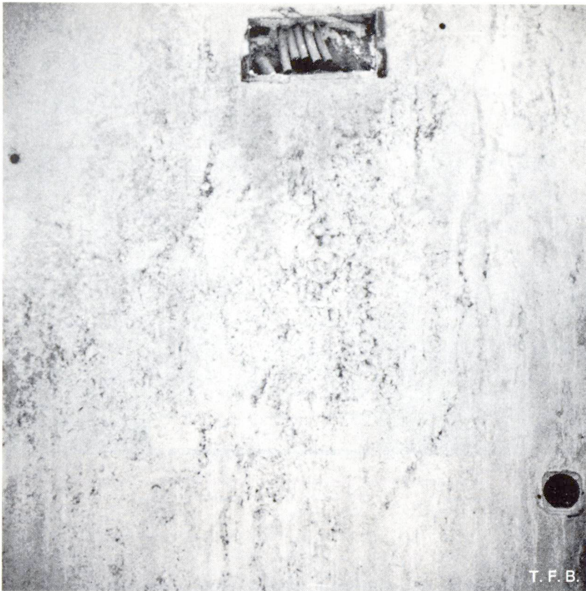
Abb. 5 Wasserausscheidung im Bereich der Schalungsfläche infolge eines zu hohen Wassergehaltes. Die Betonmischung wurde auch zu wenig durchgearbeitet.
