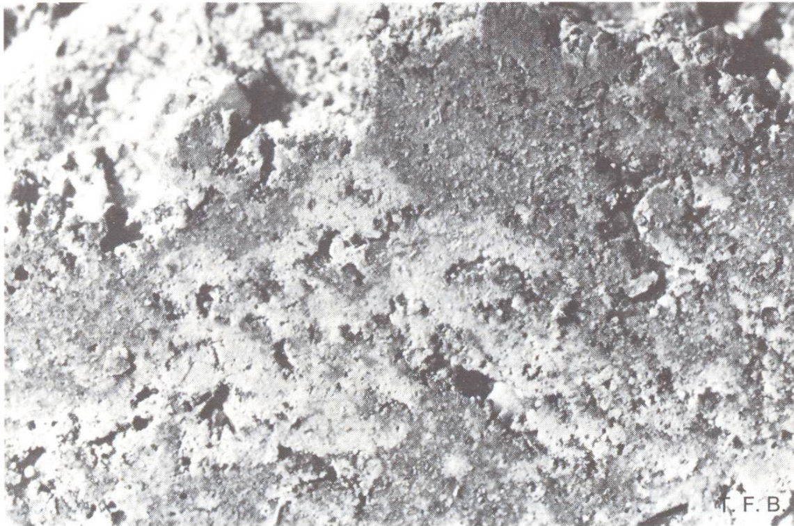
Abb. 1 Vergrößerte Wiedergabe einer Betonoberfläche aus glatter Schalung. Man erkennt eine stark heterogene Struktur infolge kleinräumiger Entmischungen: milchglasähnlicher Zementstein mit verschiedenen Tönungen infolge Wassergehaltsverschiebungen – Sandkörner – Reste unhydratisierten Zements – kleine Agglomerate von ausgeschiedenem Kalk. Auch Grobporen tragen als schwarze Punkte zum Grauton bei. Die Bildbreite entspricht ungefähr 10 mm.
