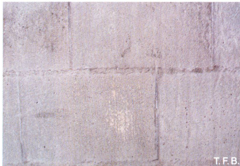
Abb. 10 Dieser «Zementanwurf» gleicht eher einer Glasur. Die dünne, feinkörnige, mit zuviel Wasser angemachte Mörtelschicht «verdurstete» auf dem stark saugenden Backstein und konnte nicht voll erhitzen.
