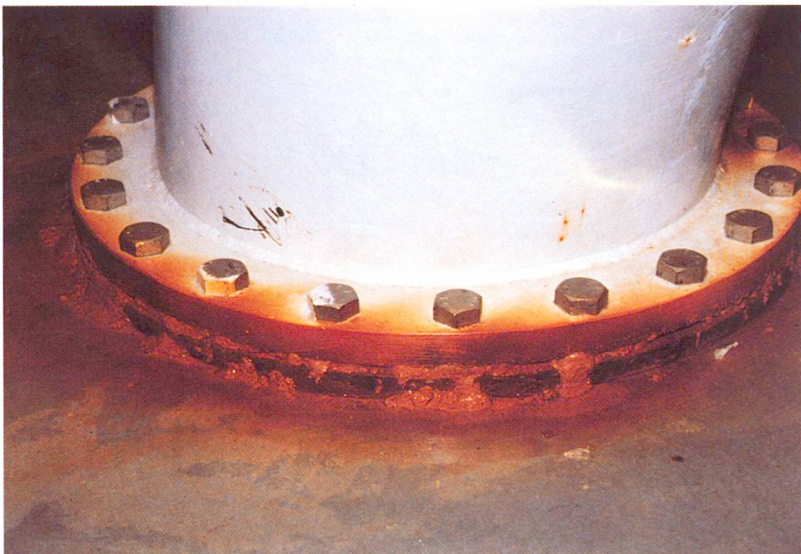
Abb. 4 Korrosionsschaden in einem Trinkwasserreservoir nach fünf Jahren Betrieb (gleiche Ausführung wie Abb. 3).
