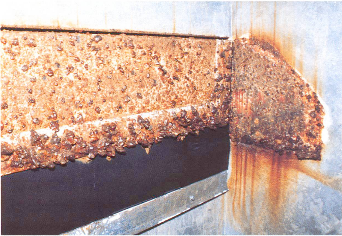
Abb. 5 Korrosionsschaden an Stauklappe eines Aktivkohlefilters nach fünf Jahren Betrieb. Verstärkte Korrosion durch Luft-Wasser-Verhältnisse mit Ozon (gleiche Ausführung wie Abb. 3).
