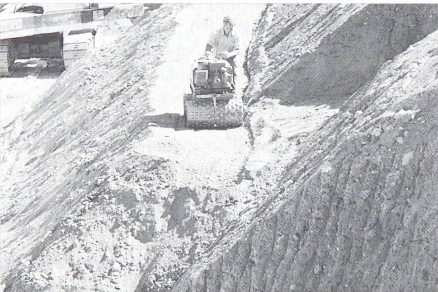
Abb. 16 Bei Steilböschungen werden horizontale Schichten eingebracht (Arbeiten mit Bermen wie bei Grossbaustellen)
