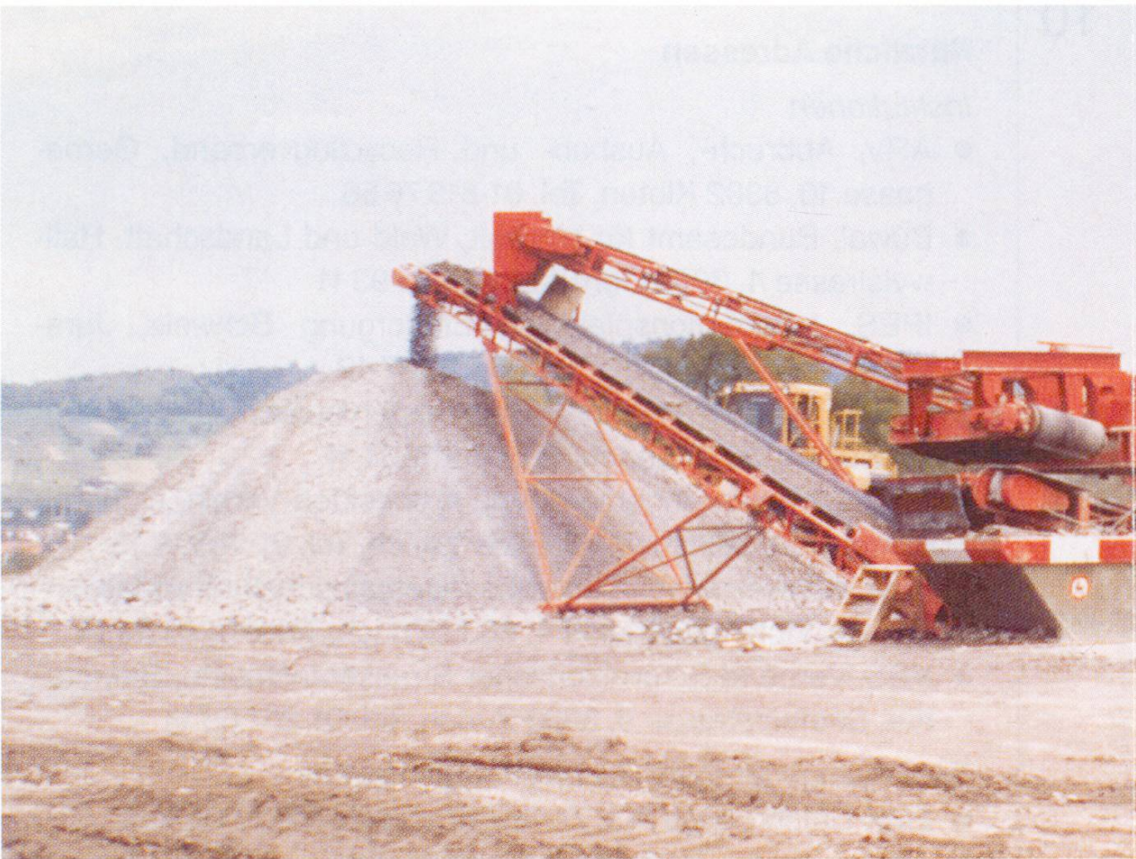
Bauschutt-Aufbereitungsanlage in Betrieb.
