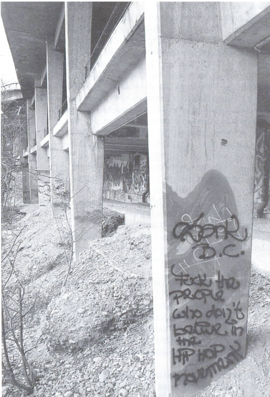
Unter dem Bahnhofplatz Baden: Durch undichte Stellen auf der Oberseite des mehrstöckigen Bauwerks drang chloridhaltiges Wasser ein, das in den abgebildeten Stützen zu starken Korrosionsschäden führte. Diese wurden durch kathodischen Korrosionsschutz ohne Veränderung der Tragwirkung der Stützen behoben (kein Beton entfernt). (Foto: Kurt Haberstich, TFB)
