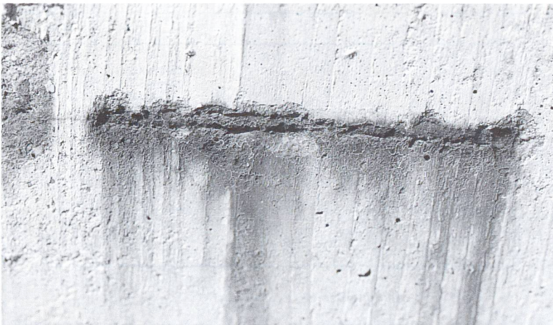
Abplatzungen als Folge von Bewehrungskorrosion.
