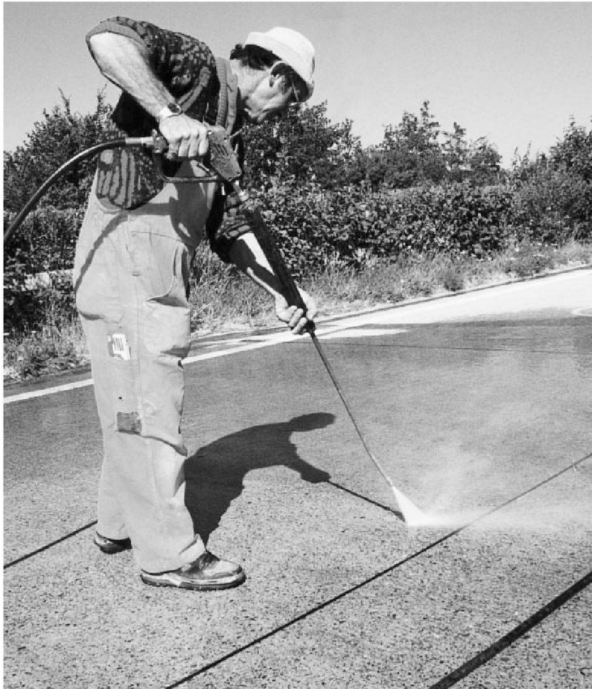
Reinigung einer Testfläche für die Hydrophobierung einer rund 16 Jahre alten Betonstrasse mit Hochdruckwasser (200 bar).
